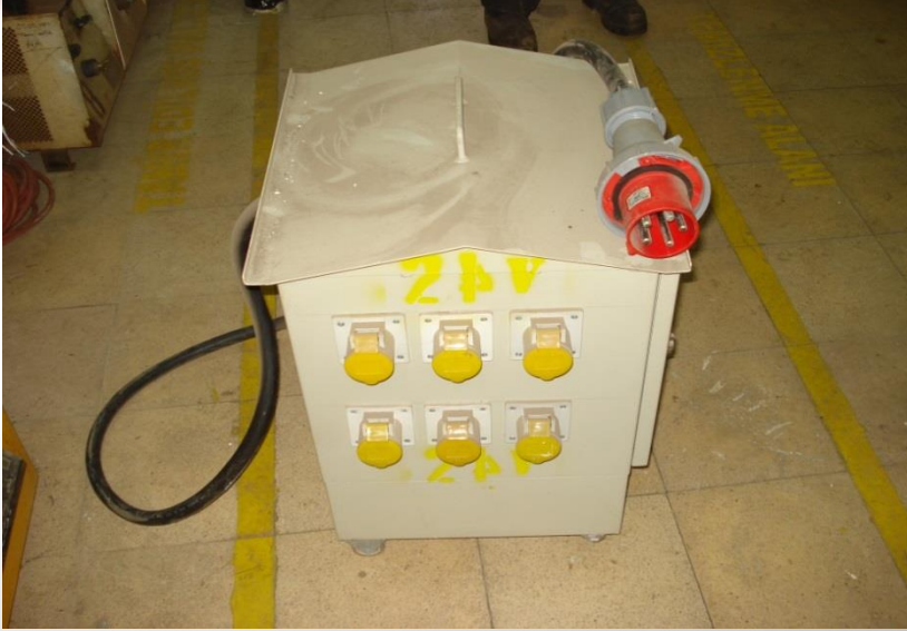
Küçük gerilim için kullanılan 24 V Trafo panosu
